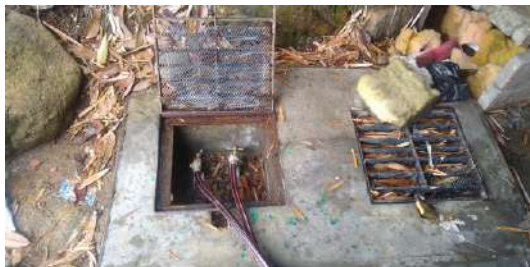
Contador de agua
