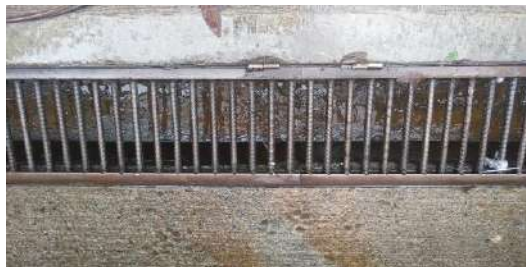
Rejilla para recolección de aguas residuales
