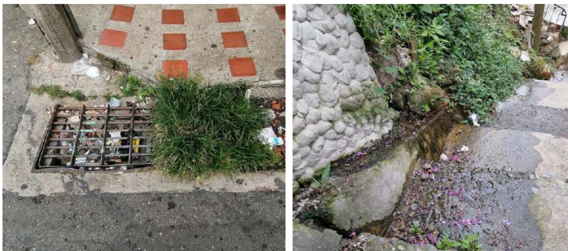
Ilustración 40 Registro fotográfico Manejo inadecuado del agua. Fuente: Elaboración propia – Recorridos auxiliares de campo
